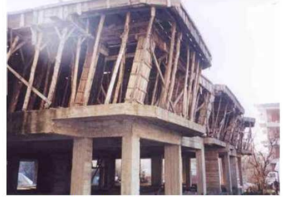
Yeterli çapraz eleman olmaması nedeniyle kalıp göçmesi
