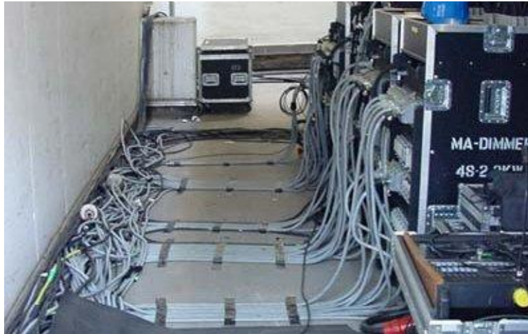
Resim 2.10: Dimmerler ve dimmer odası
